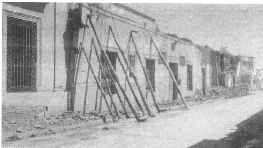
Fig. 6. Fotografía de la casa natal de Domingo Faustino Sarmiento después del terremoto de 1944. Obsérvese como el frente está apuntalado para evitar el derrumbe de la vivienda. La casa de Sarmiento es el Primer Monumento Histórico Nacional en Argentina. Años más tarde la casa fue reparada respetando el estilo de construcción y formas originales.
